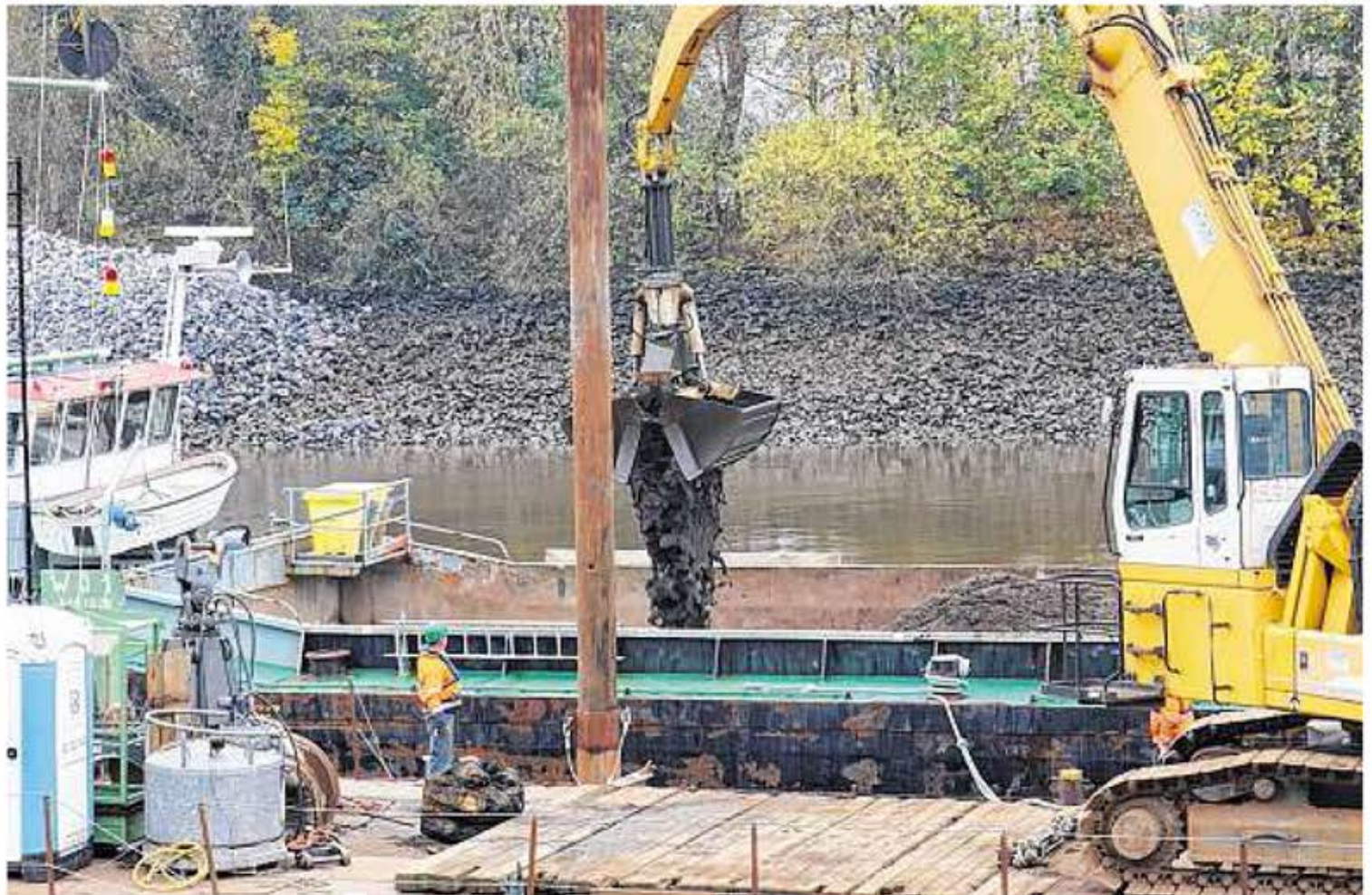
Der Bagger lässt den Schlick in die Schute fallen. Das unbelastete Material wird anschließend in der Weser verklappt.
