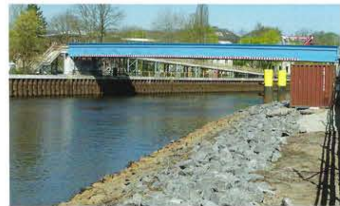
Die Oldenburger Cäcilienbrücke von 1927 ist bald Geschichte. Seit dem 24. April hat eine vom WSA gebaute Behelfsbrücke für Radfahrer und Fußgänger den Betrieb aufgenommen – ein imposanter blauer Stahlbalken über die Hunte. (Foto: Kahnwald)
