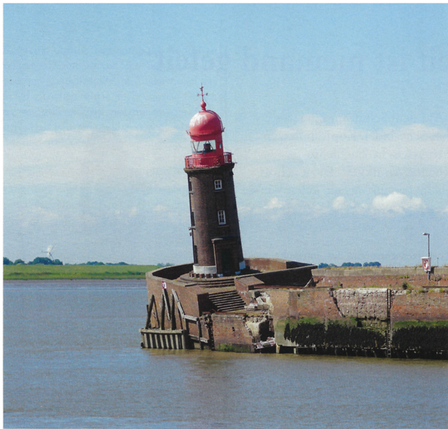
Der schiefe Turm von Bremerhaven: In den frühen Morgenstunden des 18. August stürzten Teile der Nordmole im Geestevorhafen von Bremerhaven ein. Der Leuchtturm auf dem Molenkopf – ein denkmalgeschütztes Wahrzeichen der Stadt – neigte sich mit seiner gesamten Plattform gefährlich Richtung Geeste. (Foto: Katrin Leduc)
